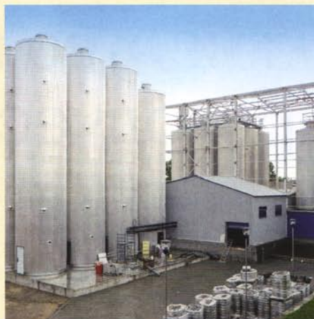
2010: танки, смонтированные на раме из нержавеющей стали, были установлены на бетонном полу с интегрированной анкерной плитой
